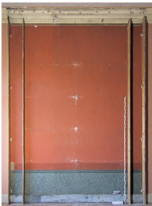
Freigelegte Originalfassung von 1876 in der Abgussammlung im 1. Obergeschoss 2020, Foto: Ingenieurbüro für Denkmalpflege, Rudolstadt
